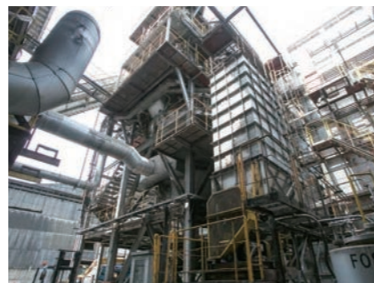
No.1焼却炉(流動床炉)
