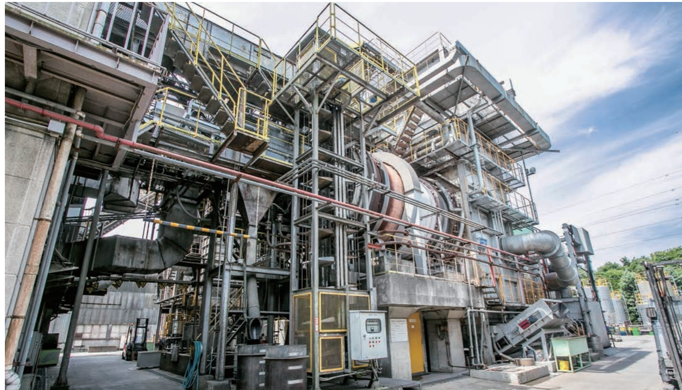
No.2焼却炉(ロータリーキルンおよびストーカ炉)
