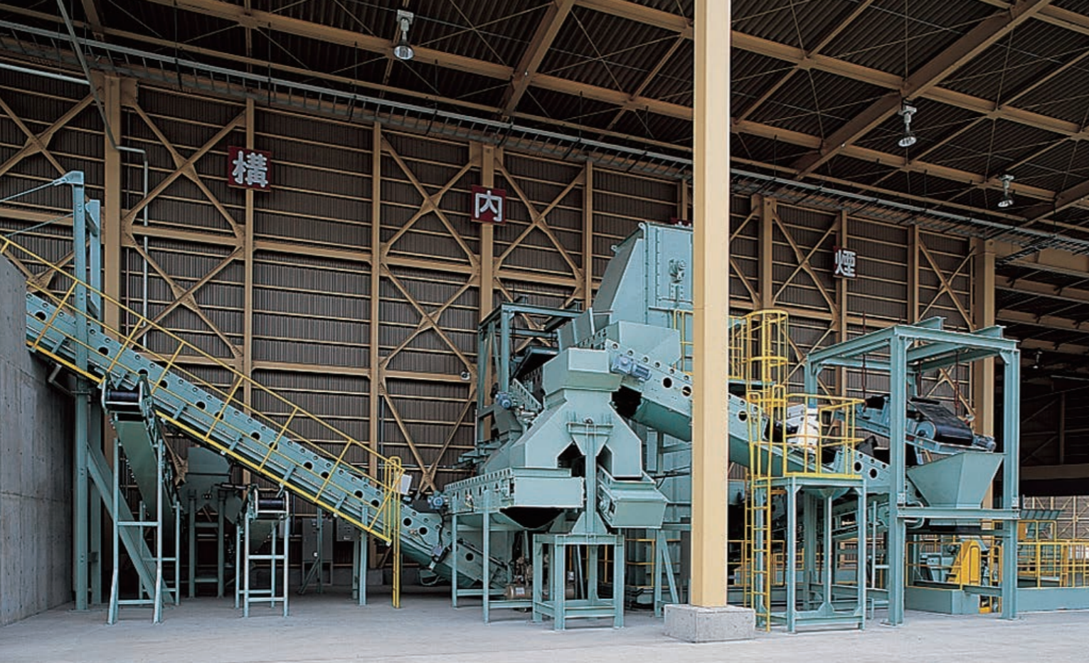
破碎施設(木くず破碎機)
